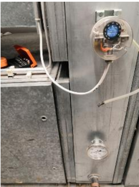
Kuva 9. Katkennut LTO-kammion paine-eronanturin letku.
