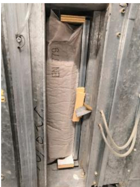
Kuva 17. Puukiloilla tuettu ja puulistoilla korjattu poistoilmasuodatinten kiinnityskehys.
