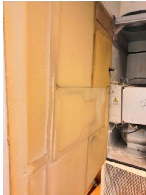
Kuva 30. IV-koneen yläosan oven likaisia ja huonokuntoisia äänieristeitä.
