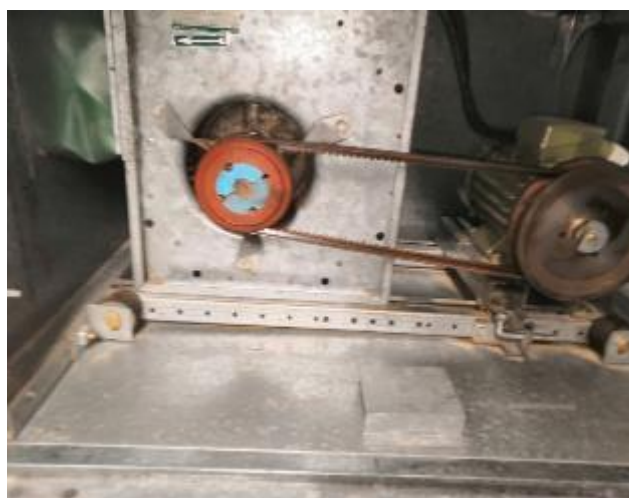
Kuva 26. Yleiskuva tuloilman puhallinmoottorista.
