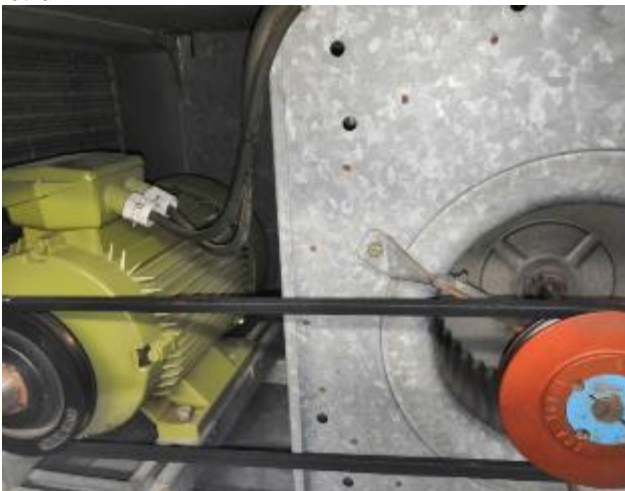
Kuva 11. Yleiskuva tuloilman puhallinmoottorista.
