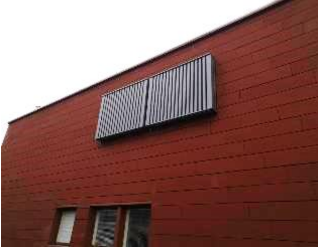
Kuva 1. Vanhan osan IV-konehuoneen raitisilmasäleikkö.
