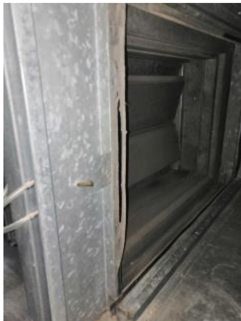
Kuva 6. Rikkoontunut suodatinkammion tiiviste.
