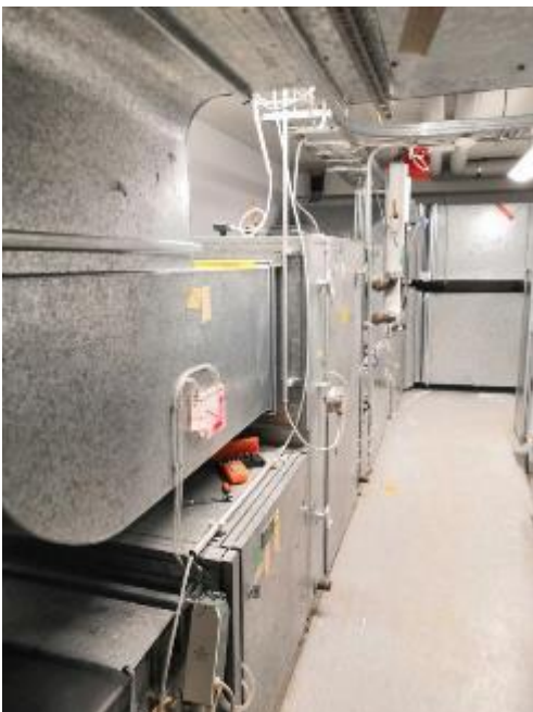
Kuva 5. Yleiskuva ilmanvaihtokoneesta TK1/PK1.
