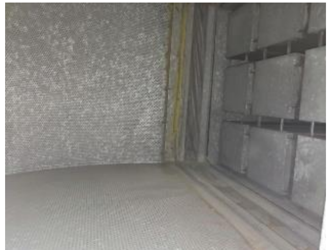
Kuva 12. Yleiskuva äänieristyskammioista ja -kennoista.
