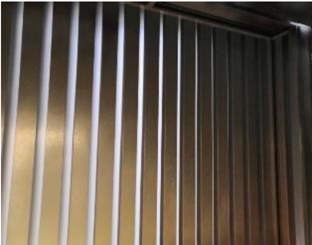
Kuva 3. Vanhan osan IV-konehuoneen raitisilmasäleikkö.
