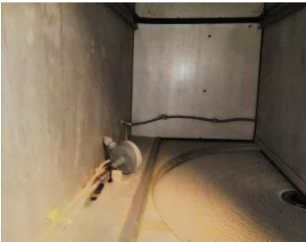
Kuva 33. Tuloilmasuodatinkammio ja LTO-kennostoa.
