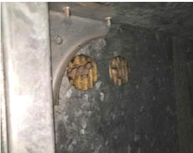
Kuva 21. Tiivistämättömät läpiviennit poistoilmapuhallinkammiossa.
