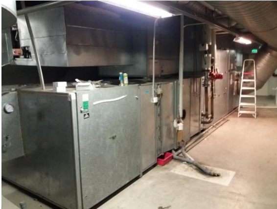
Ilmanvaihtokone TK 1 / PK 1.
